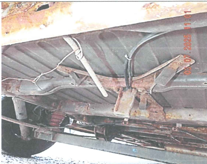
Wsporniki mocowania podłogi, głęboko skorodowane.
