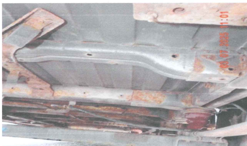
Wsporniki podłogi, głęboko skorodowane.
